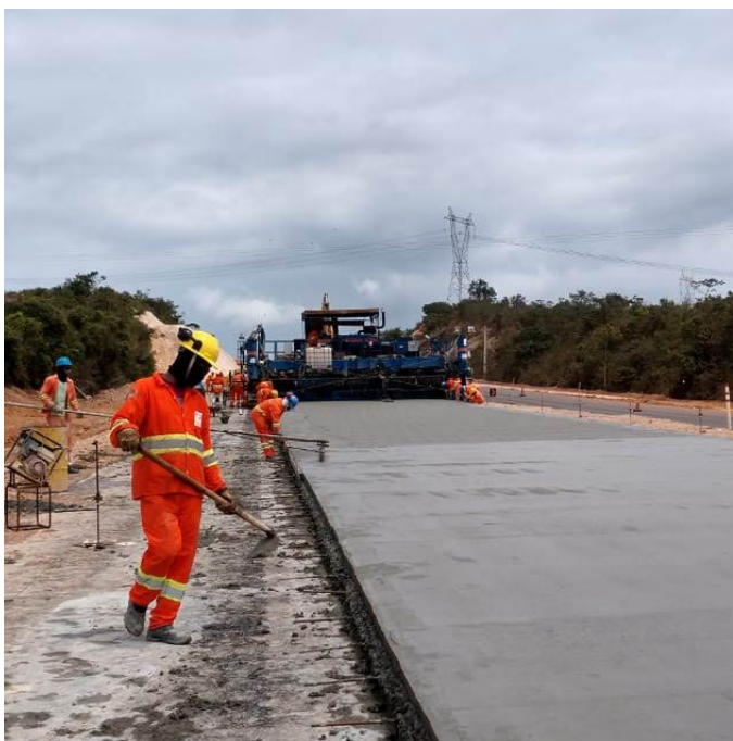
Aplicação de pavimento rígido com tecnologia MOBA Foto: cedida pelo entrevistado, Waldir Soares
